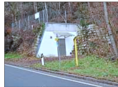
Auch der Wasserpreis wurde bei der letzten Gemeinderatsitzung angepasst. Hier der Hochbehälter in der Matzenberger Straße.
