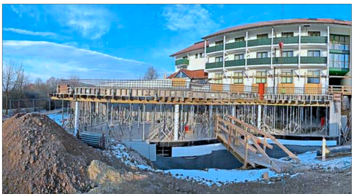
Der künftige Ruhebereich des Hotels Sonnengut ist eine Baustelle. Das Dach wird begrünt, die Außenanlagen noch angelegt. Der Rohbau aber ist pünktlich vor Weihnachten fertig geworden. – Fotos: red/Gröll
