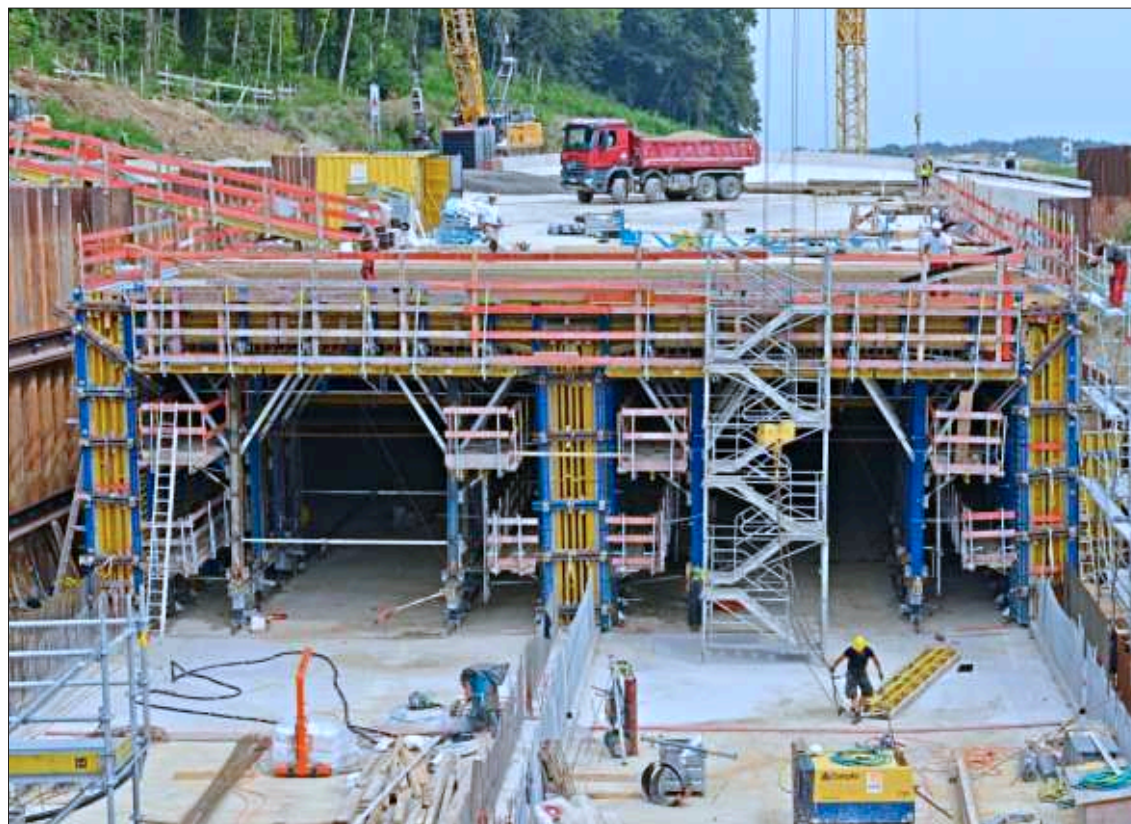
Auf der A 94-Großbaustelle in Tutting geht es voran – derzeit wird an der Einhausung gearbeitet. Die wachsende A 94 bringt eine wirtschaftliche Entwicklung mit sich. Die Gemeinden der ILE an Rott & Inn wollen diese mit Gewerbegebieten nutzen. – Foto: Archiv Schlegel
