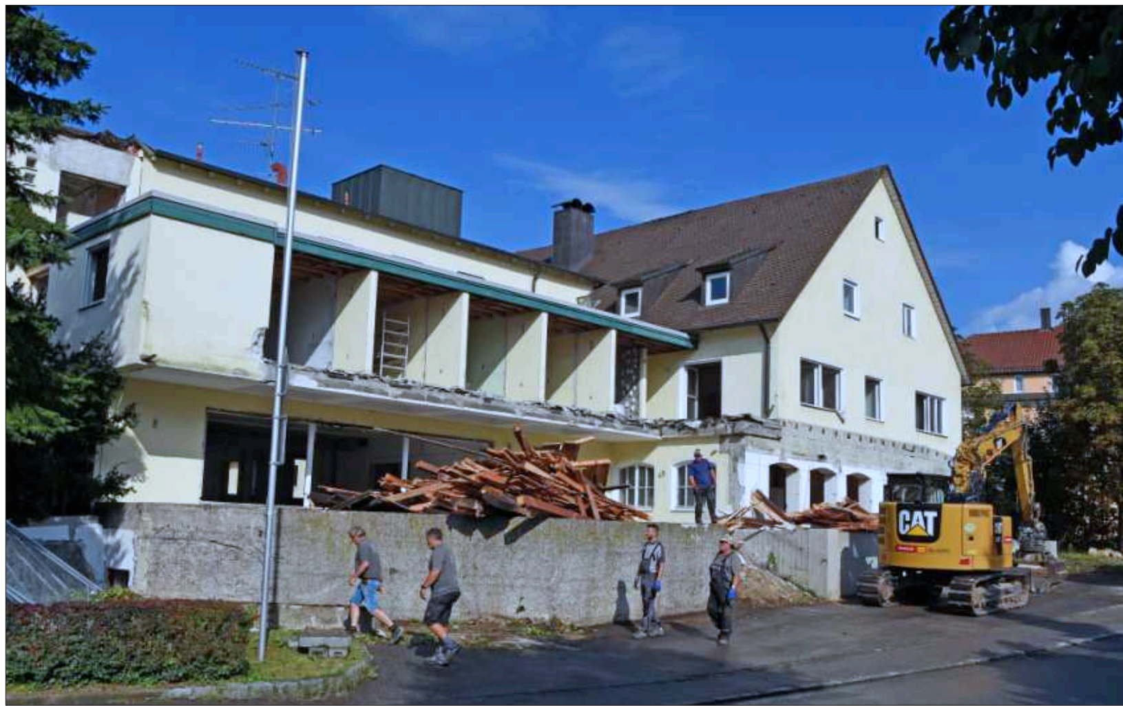
Schweres Gerät ist vor dem „oid'n Mathäser“ bereits vorgefahren: Vor dem Abbruch des Hoteltrakts (hinterer Teil) muss jedoch das alte Gasthaus (r.) mit Giebeldach fertig entkernt und in den Rohbauzustand versetzt werden. Nach den Gewerksausschreibungen (Oktober) ist der Baubeginn des neuen Mathäser-Areals samt Bürgersaal für nächsten März geplant. – Foto: Nöbauer
