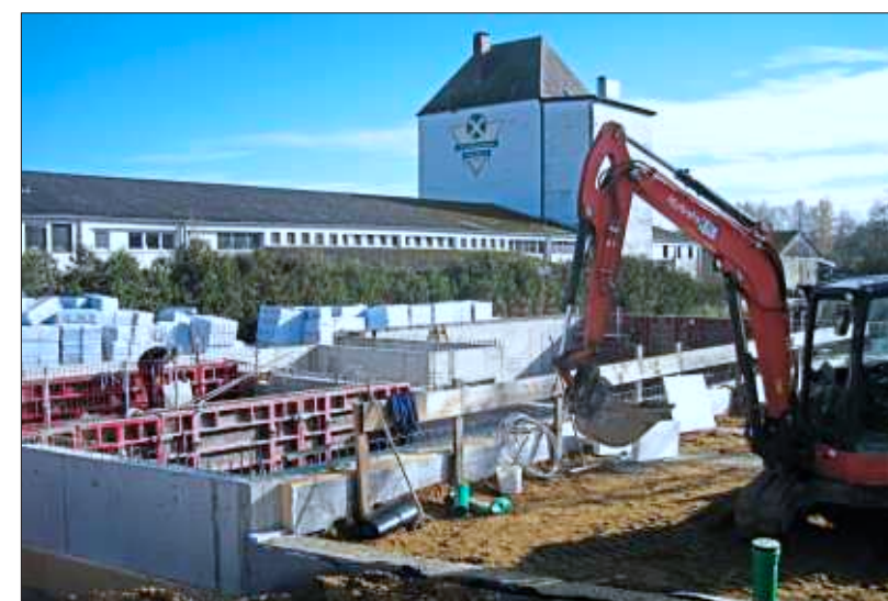
Jetzt werden die Außenwände hochgezogen: Auf der Baustelle der Montessorischule wird wieder gearbeitet. – Foto: Lebmann
