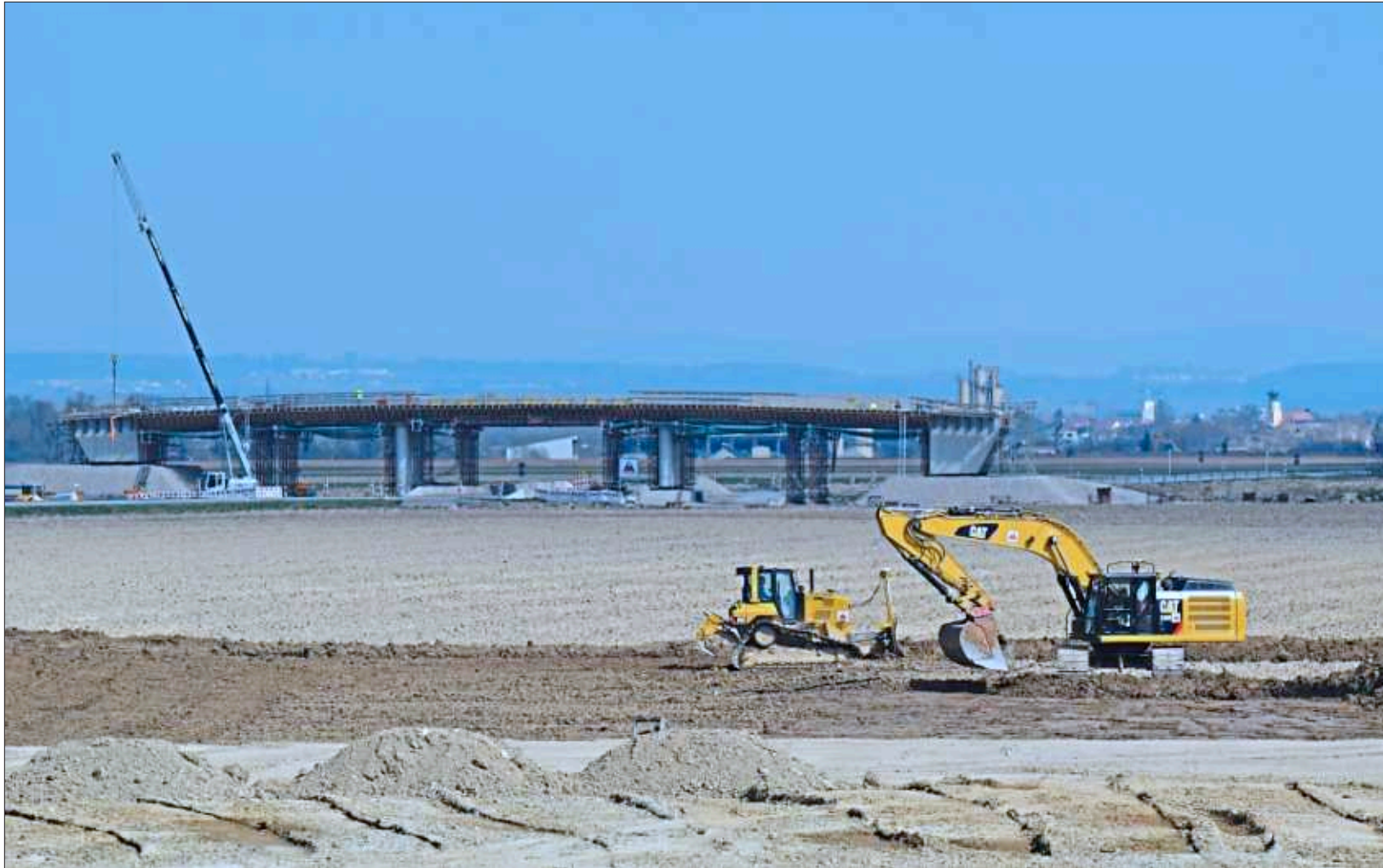
Sieht nach Großbaustelle aus – und ist auch eine: Eine Brücke über die künftige Streckenführung der A 94, über die die Landwirte später ihre Felder erreichen können, steht bereits. Am restlichen Entstehen des Teilstücks zwischen Kirchham und Pocking wird weitergewerkelt. – Foto: Jörg Schlegel
